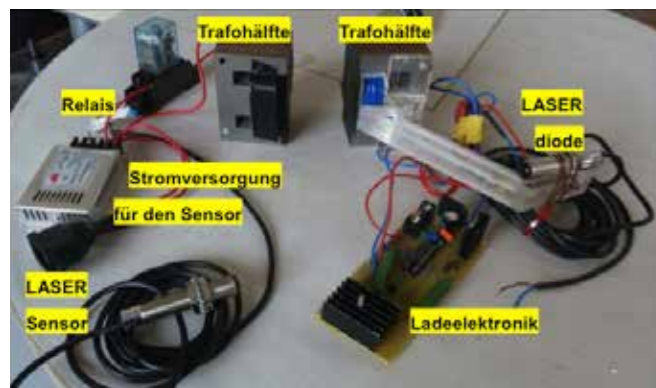
Bild 19 Die Komponenten der Ladestation links Teile der Ladestation rechts Teile im Robotino Autor: Dr. Hans Wiedmann
